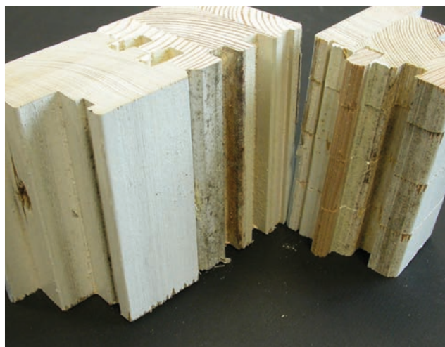
Bild 8.3: Geöffnete Fensterkonstruktion mit erkennbarer Schimmelpilzbildung an den von der Raumseite offenen Konstruktionsfugen
