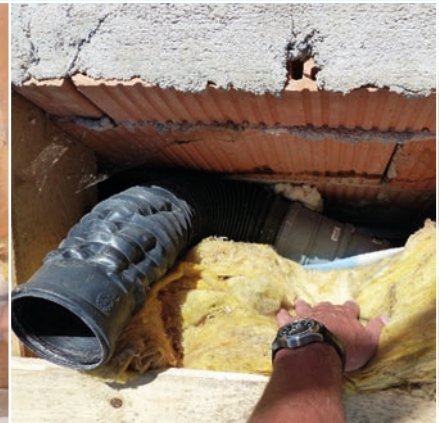
Fehlstellen in der Luftdichtheitsschicht, Öffnung zum Innenraum (primäre Leckage)
