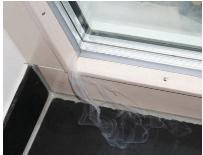
Bild 8.6: Leckage zum Glasfalz über die Glashalteleisten
