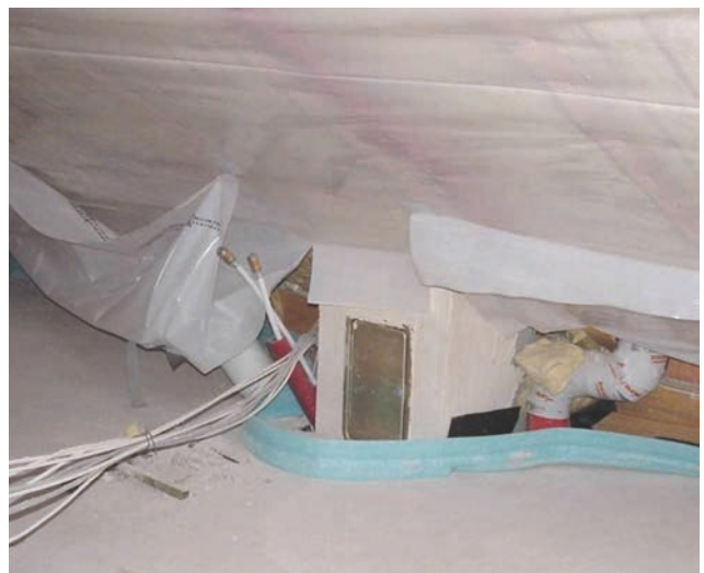
Bild 3.18: Offene Anschlüsse im Bereich von Durchführungen
