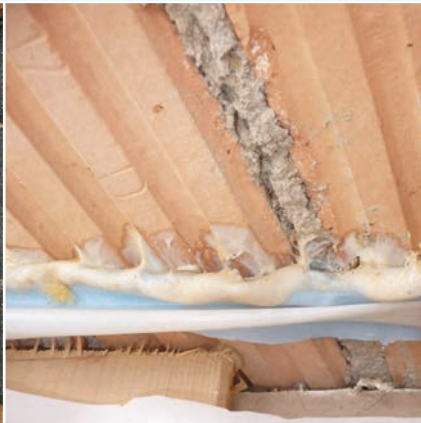
Luftdichtheitsschicht an unverputztes Mauerwerk angeschlossen (primäre Leckage)
