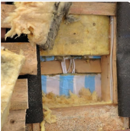
Fehlstellen in der Luftdichtheitsschicht im Bereich von Kabeldurchführungen (primäre Leckagen)
