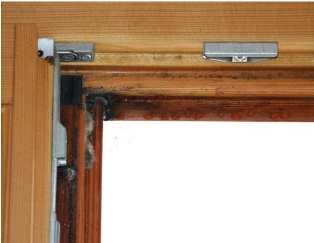
Bild 8.5: Tauwasser- und Schimmelpilzbildung im Falz des Stulpbereiches eines 2-flg. Holzfensters als Folge der Durchströmung der Konstruktion, da die Wirkung der Dichtebene 1 nicht gegeben ist
