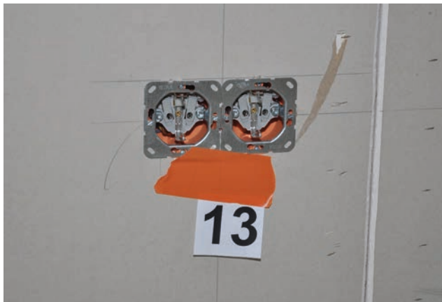
Bild 1.13: Steckdosen in einer Außenwand in Holzbauweise im 1. Obergeschoss. Der Volumenstrom durch die Leckage bei 50 Pa, ca. 1 m³/h, war den TeilnehmerInnen nicht bekannt (FLiB 2015)
