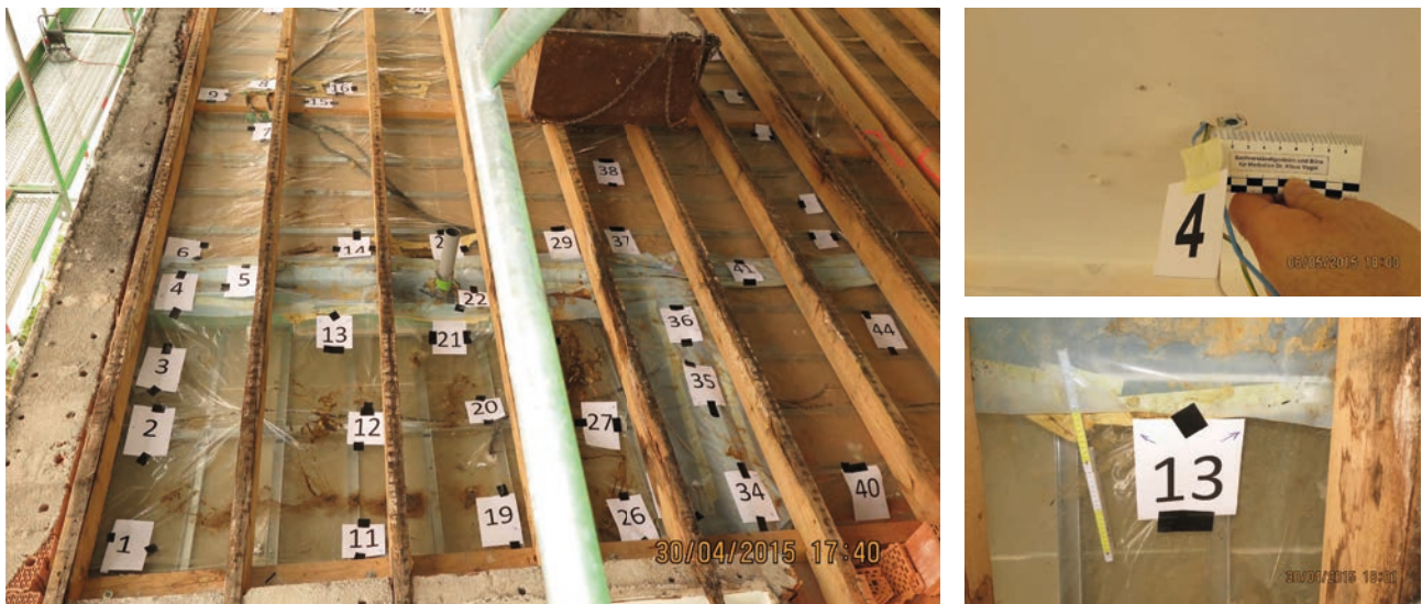
Bild 5.13: Dokumentation der Leckagen (links: Blick von außen auf Nummerierung der Leckagen in der Dampfbremse, oben rechts: Blick von innen auf eine Leckage in der Gipskartonbekleidung, unten rechts: Blick von außen auf eine Leckage im Bereich des Schachtes an einer Folienüberlappung)
