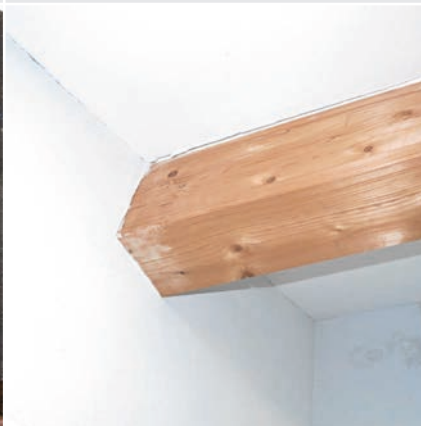
Abrisse der inneren Bekleidung im Bereich der Pfette (sekundäre Leckagen)
