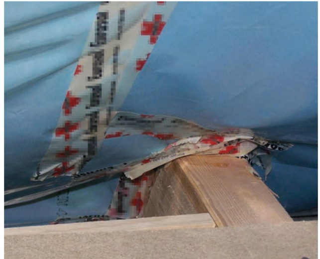
Bild 3.16: Ungeeigneter Anschluss an eine Durchdringung
