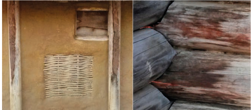
Bild 1.1: Mögliche frühzeitliche Bemühungen im Umgang mit Fehlstellen in der Gebäudehülle, dargestellt an Gebäuden im Pfahlbaumuseum Unteruhldingen/Bodensee, Bild links: Lehmputz auf „Leichtbauwand“, Bild rechts: ausgestopfte Fuge zwischen Hölzern
